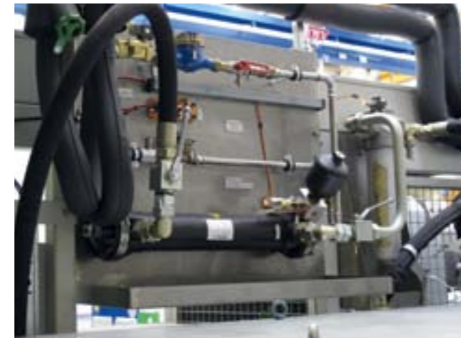
Wärmetauscher in Aktion. Egal ob zur Kühlung von Testständen oder von Hydraulikanlagen, der Sicherheitskühler ist bei der MTU vorgeschrieben.
